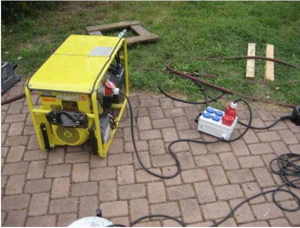
Aufbau der Stromversorgung mittels Generator mit FI-Schutzschaltern.
